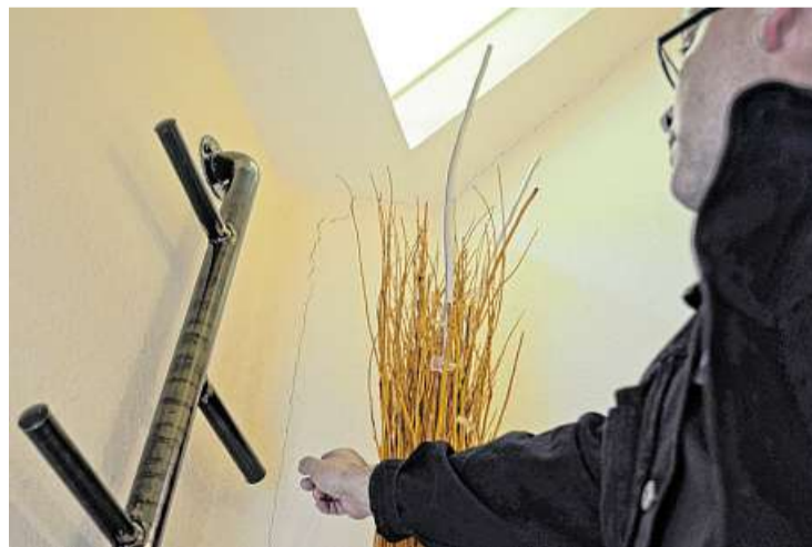
Thomas Behrens zeigt im Haus eines Nachbarn in der Arster Heerstraße auf einen Riss in der Wand, der nach Überzeugung der Bewohner aufgrund von Erschütterungen durch Schwerlastverkehr entstanden ist. FOTO: TEICHFISCHER
