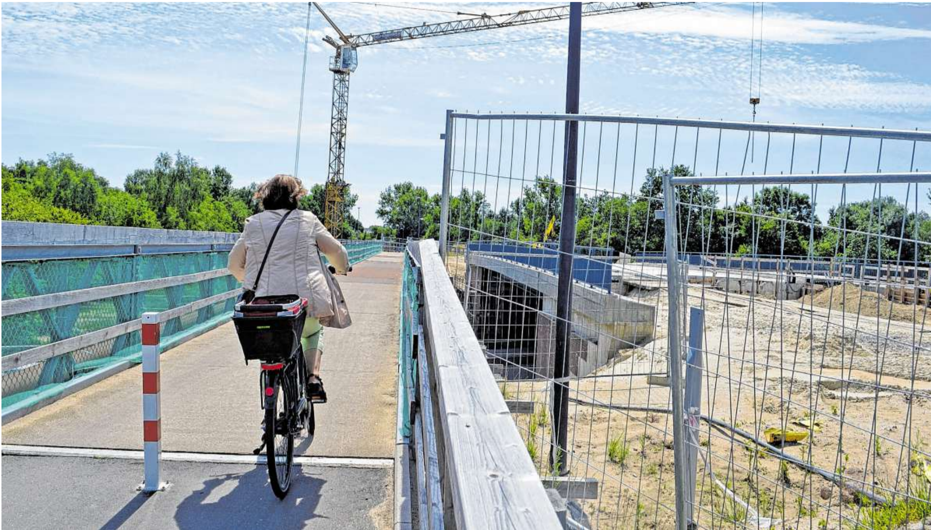
Die Arbeiten zur Erneuerung der Brücke über die B 75 (im Bild: die Nordseite) liegen nach Angaben des Amtes für Straßen und Verkehr im Zeit- und Kostenplan.
