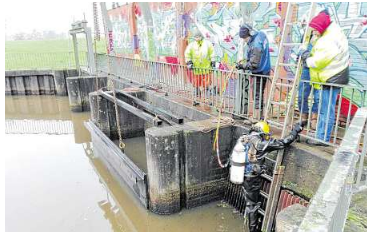
Das aus den 60er-Jahren stammende Schöpfwerk zeigt deutliche Alterserscheinungen. So ist der Beton an tragenden Elementen stark korrodiert und abgeplatzt.
